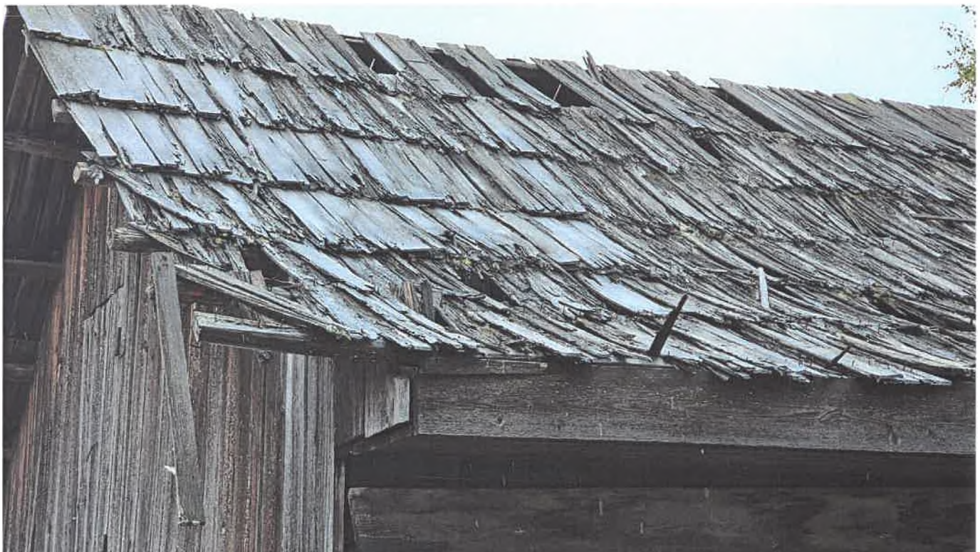
Foto 06 – Aspecte exterioare: vedere de ansamblu degradari
