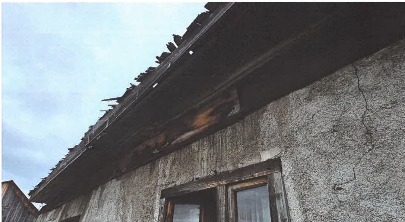
Foto 07 – Aspecte exterioare: vedere de ansamblu degradari
