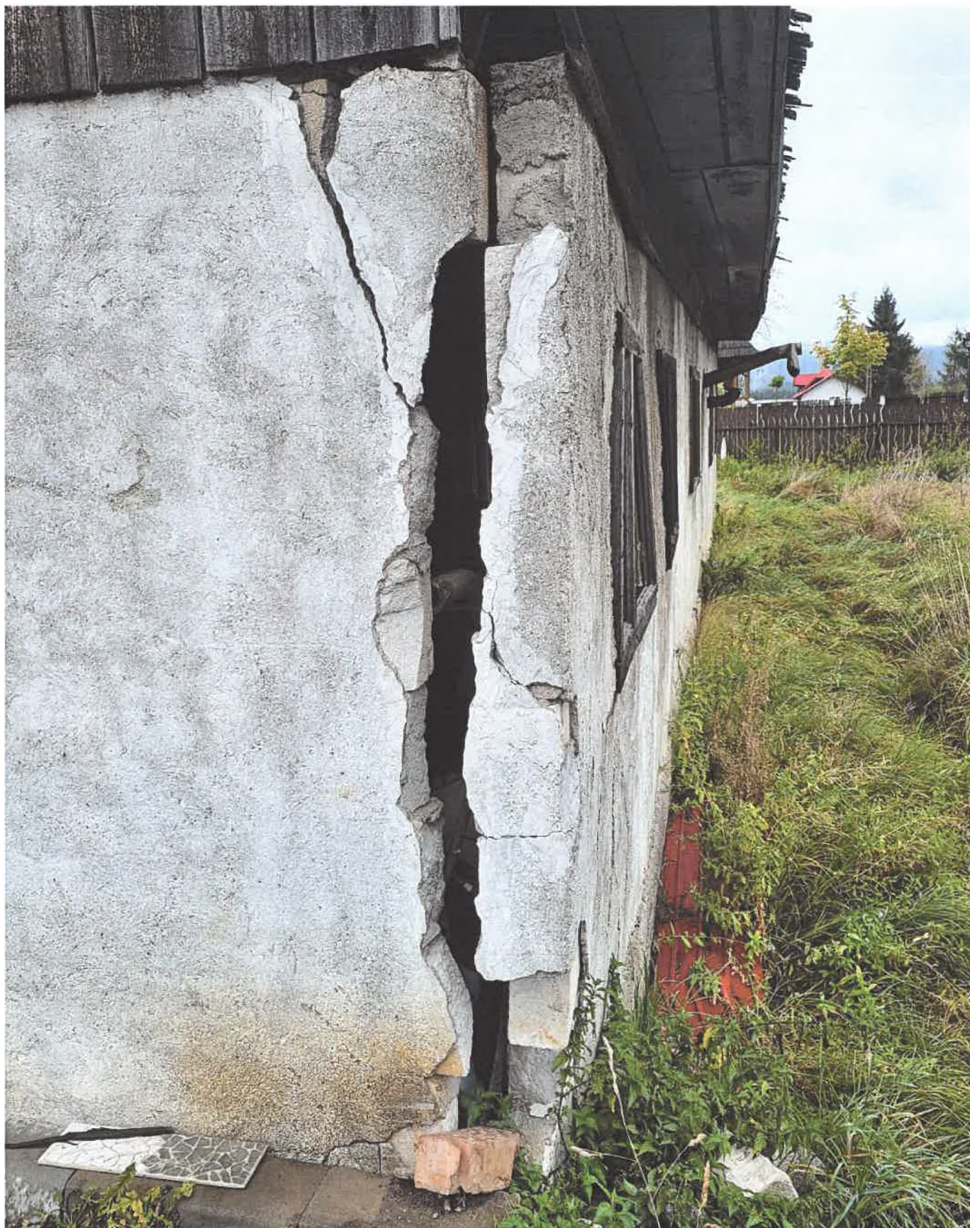
Foto 10 – Aspecte exterioare: vedere de ansamblu degradari
