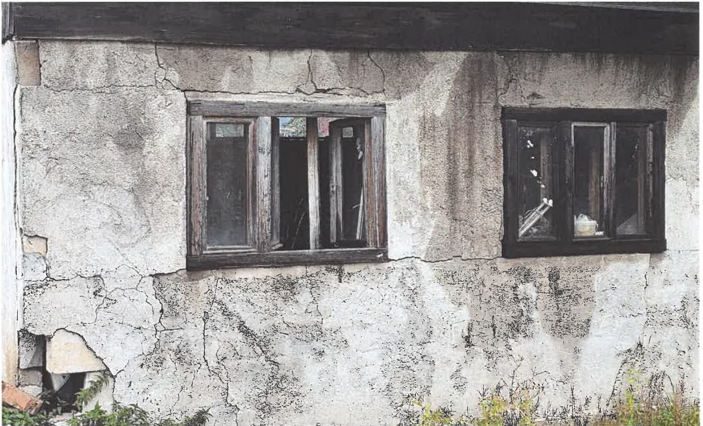
Foto 05 – Aspecte exterioare: vedere de ansamblu degradari
