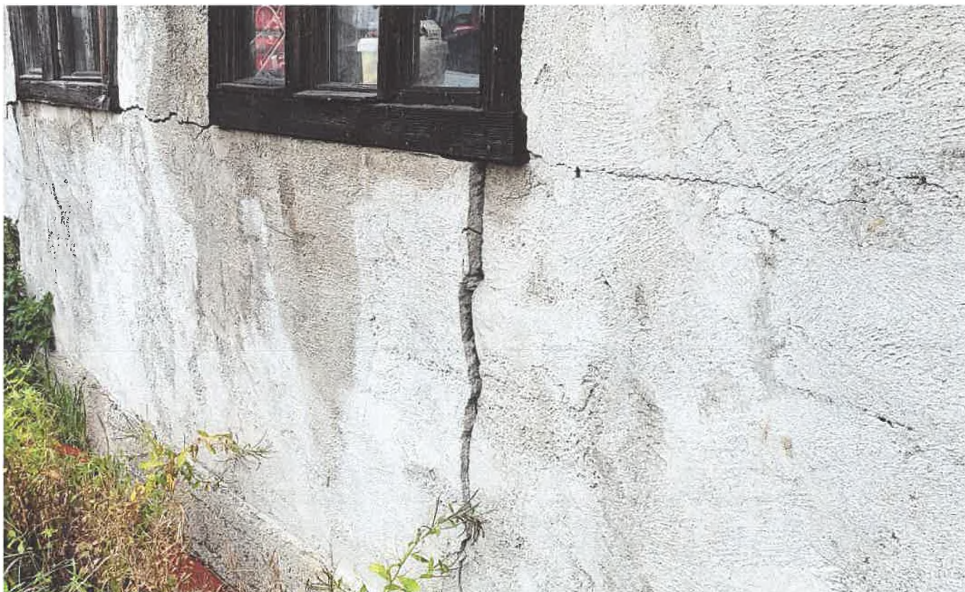
Foto 08 – Aspecte exterioare: vedere de ansamblu degradari
