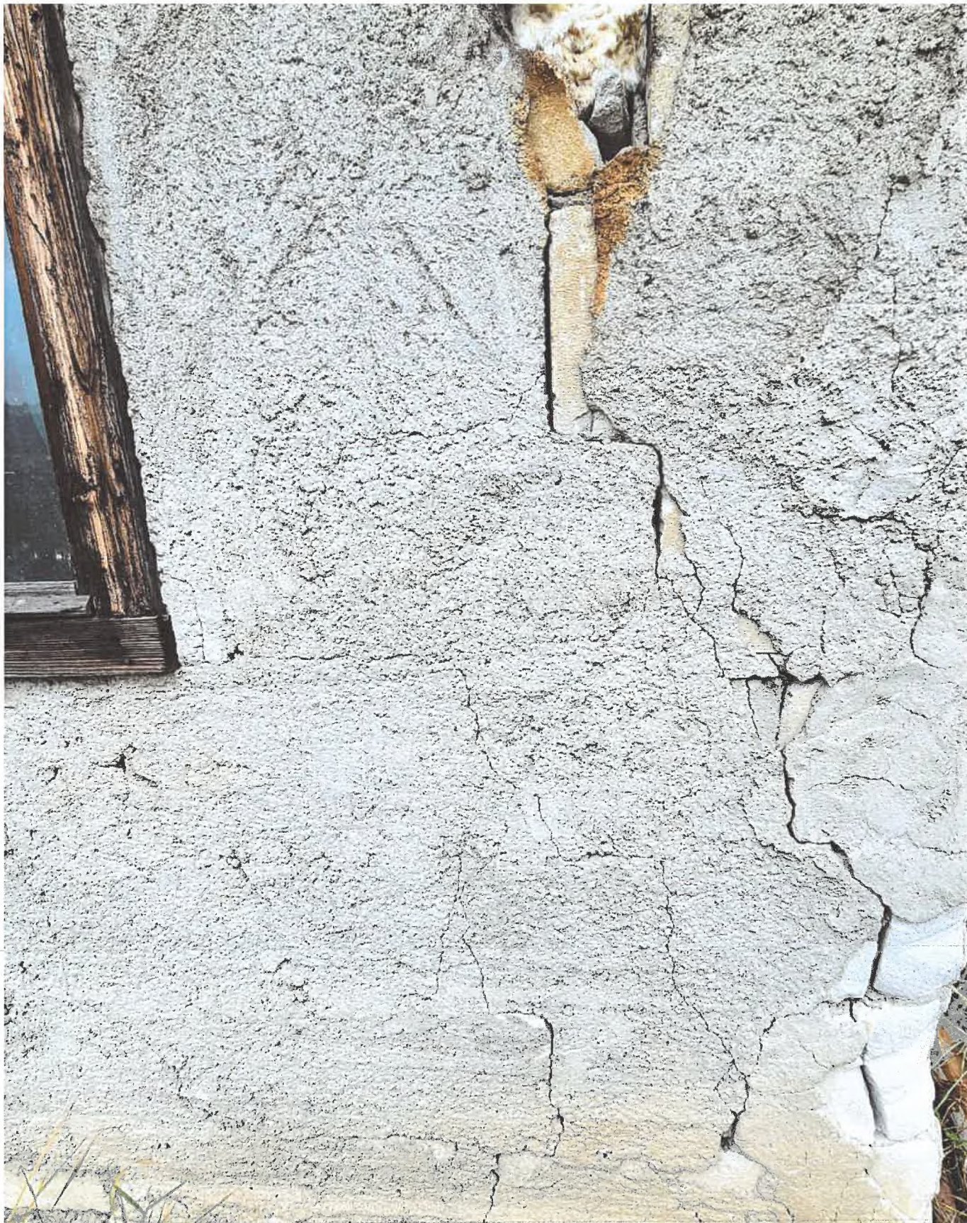
Foto 09 – Aspecte exterioare: vedere de ansamblu degradari
